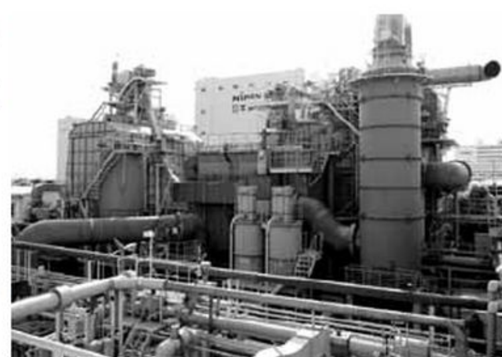
25t 木屑ボイラ
