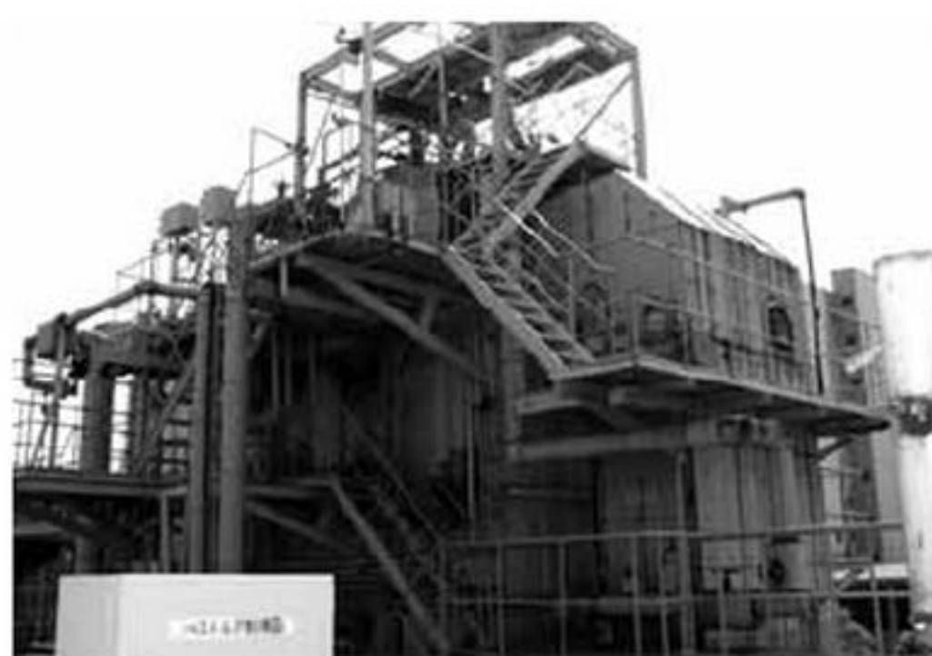
15t 木屑ボイラ
