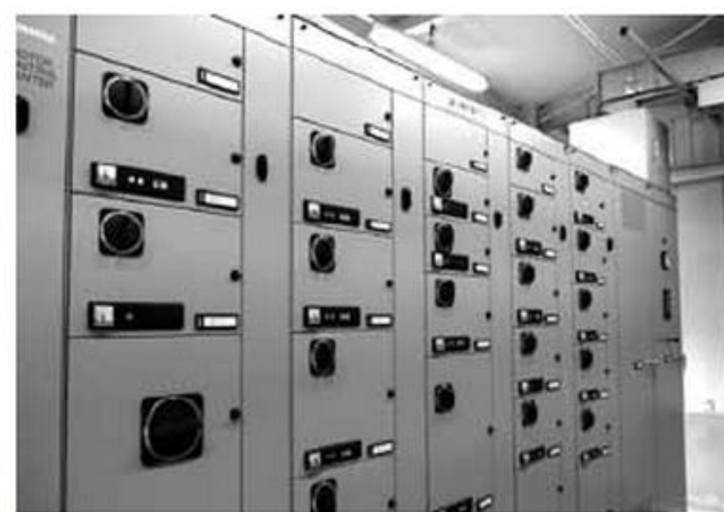
構内A系設備の電源設備
