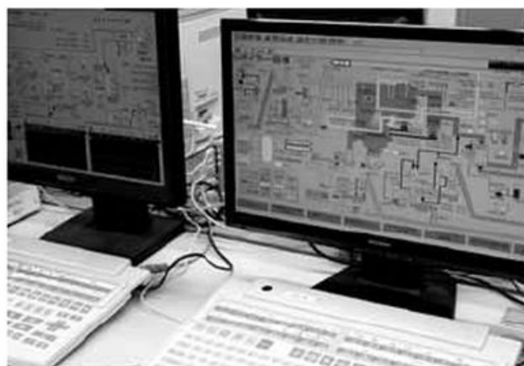
DCS化(GUIによる運転管理)
