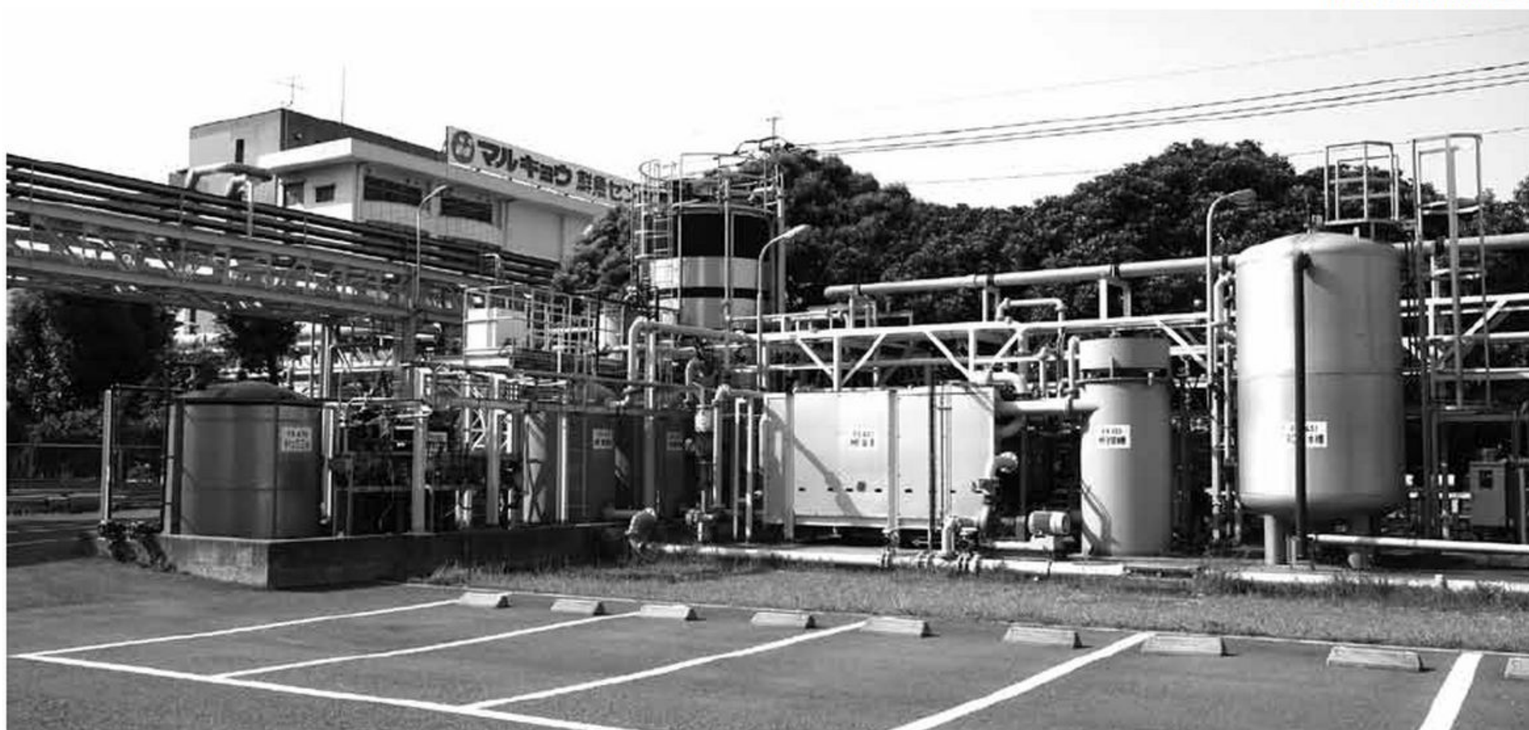
排水再利用設備全景
